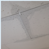
天井からの雨漏りに
